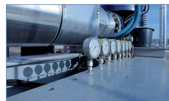
Geothermiekraftwerke in Insheim und Soultz-sous-Forêts Centrale géothermique à Insheim et Soultz-sous-Forêts
