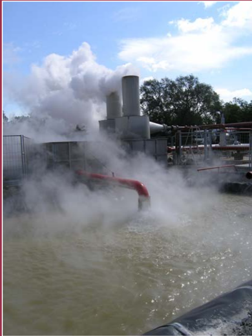
Produktionstest Geothermiekraftwerk Landau
